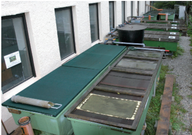
Abb. 2: Langstromrinnen auf dem Gelände der AÜW/Kempton
